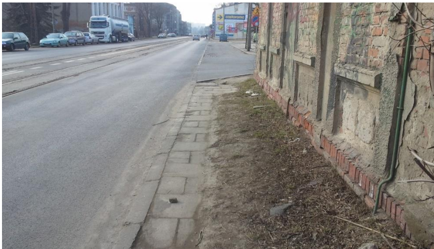
Fot 6 – ULICA WARSZAWSKA – stan chodnika (źródło: materiały ZDM w Pabianicach)
