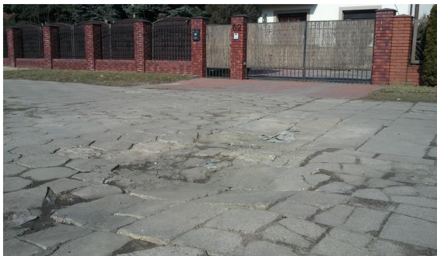
Fot 7 - ULICA WARSZAWSKA – stan chodnika (źródło: materiały ZDM w Pabianicach)
